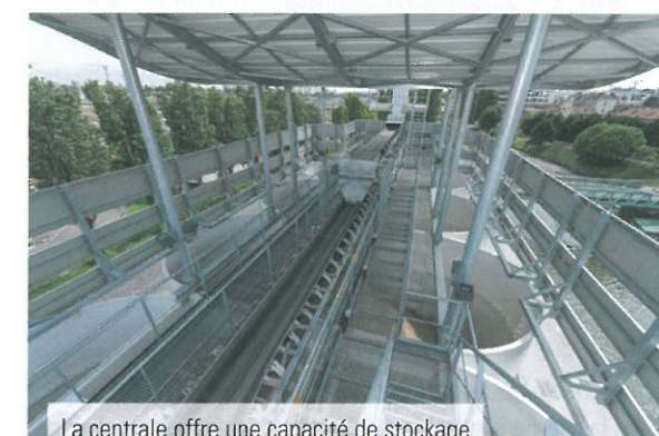
La centrale offre une capacité de stockage de plus de 1 900 t de granulats en totalité.
